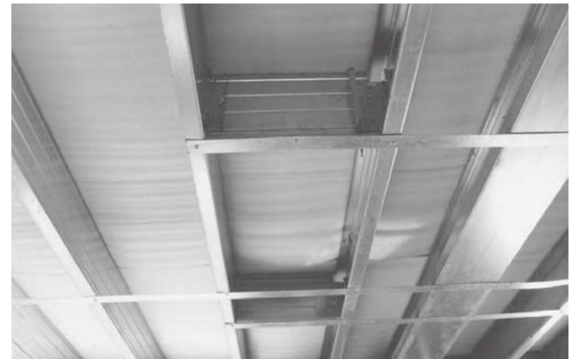
Foto 4.7 - Travamento horizontal da laje de piso por meio de bloqueadores e fitas metálicas
