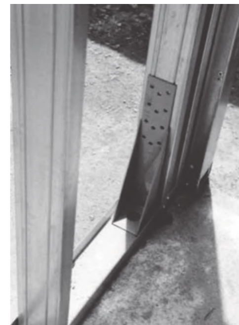
Foto 2.12 - Peça de reforço na ancoragem da estrutura à fundação por meio de barra rosca
